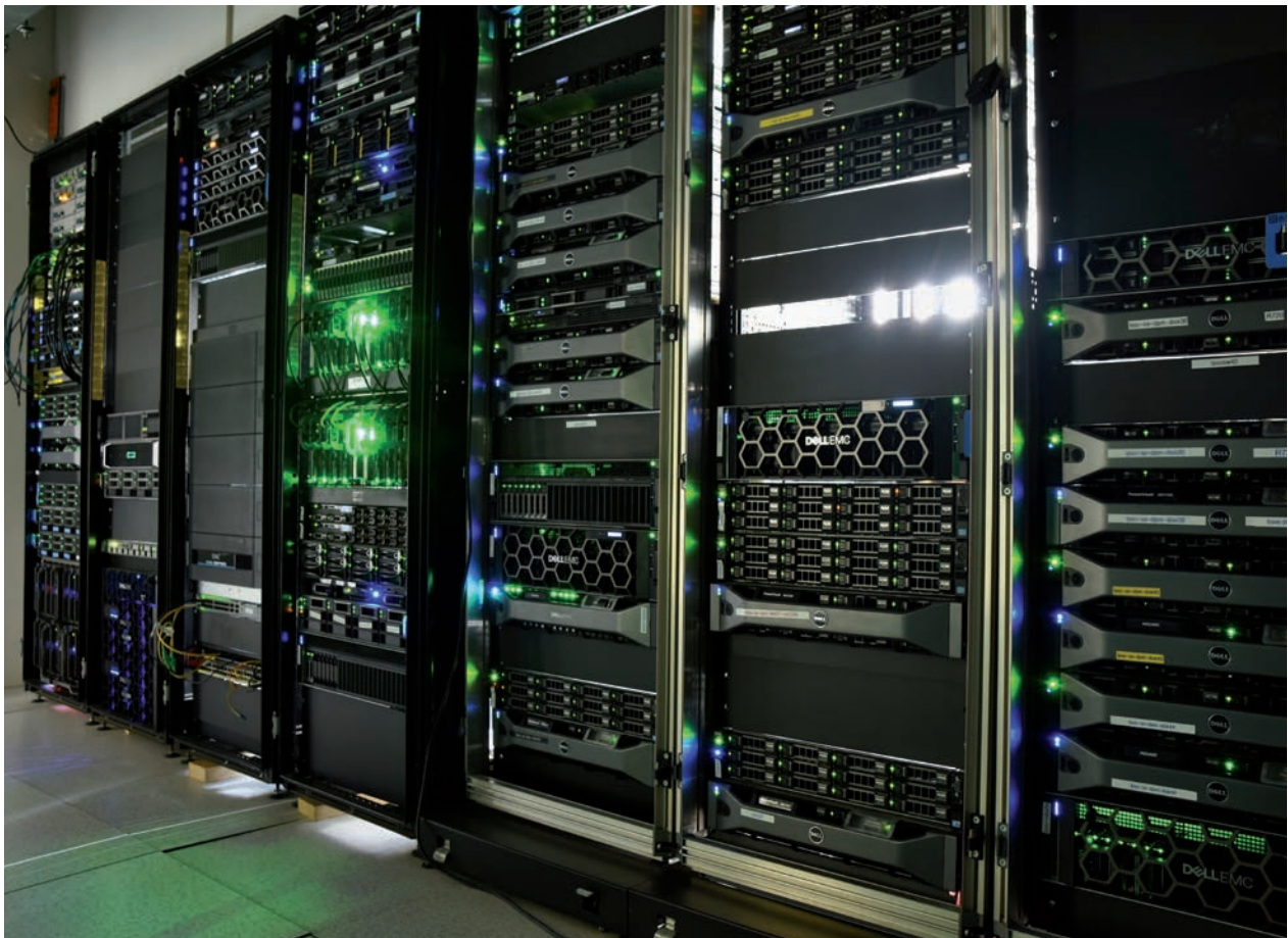
(Crédit : Dargaud 2021, LPSC). - L'entièreté des serveurs informatiques du site de Grenoble est hébergée dans notre salle machine (8 baies de 48 unités).
